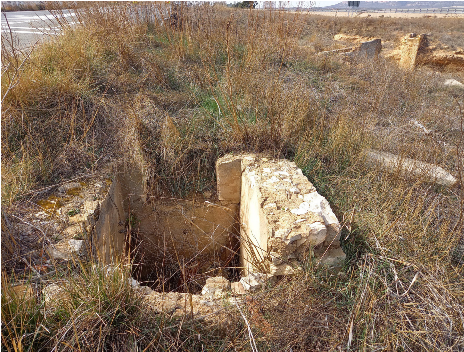
- Figura 36 - Tramo de canal aguas abajo del acueducto. Autor: J. F. García Sáez.
