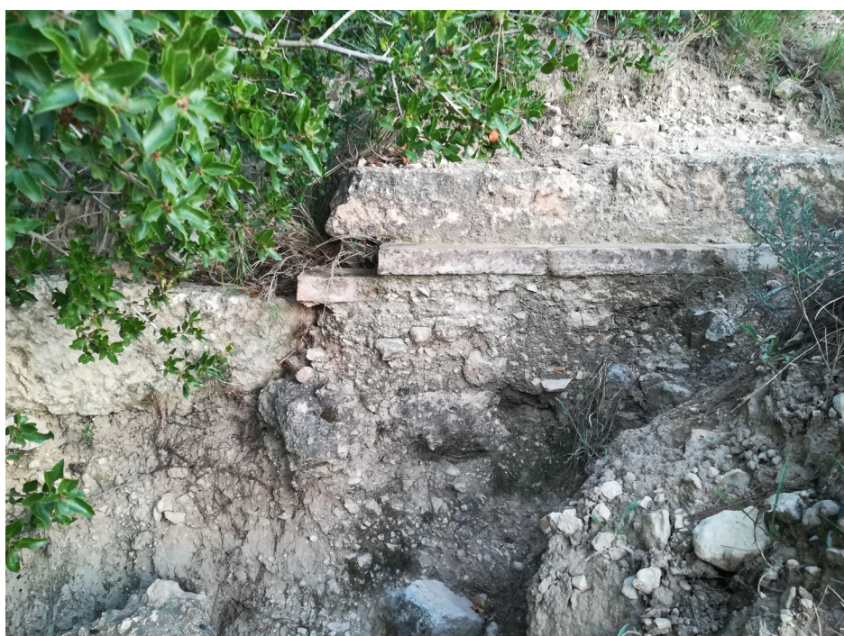
- Figura 96 - Canal colapsado que discurre entre el cuarto azud y el cad del molino Alto. Autor: J. F. García Sáez.
